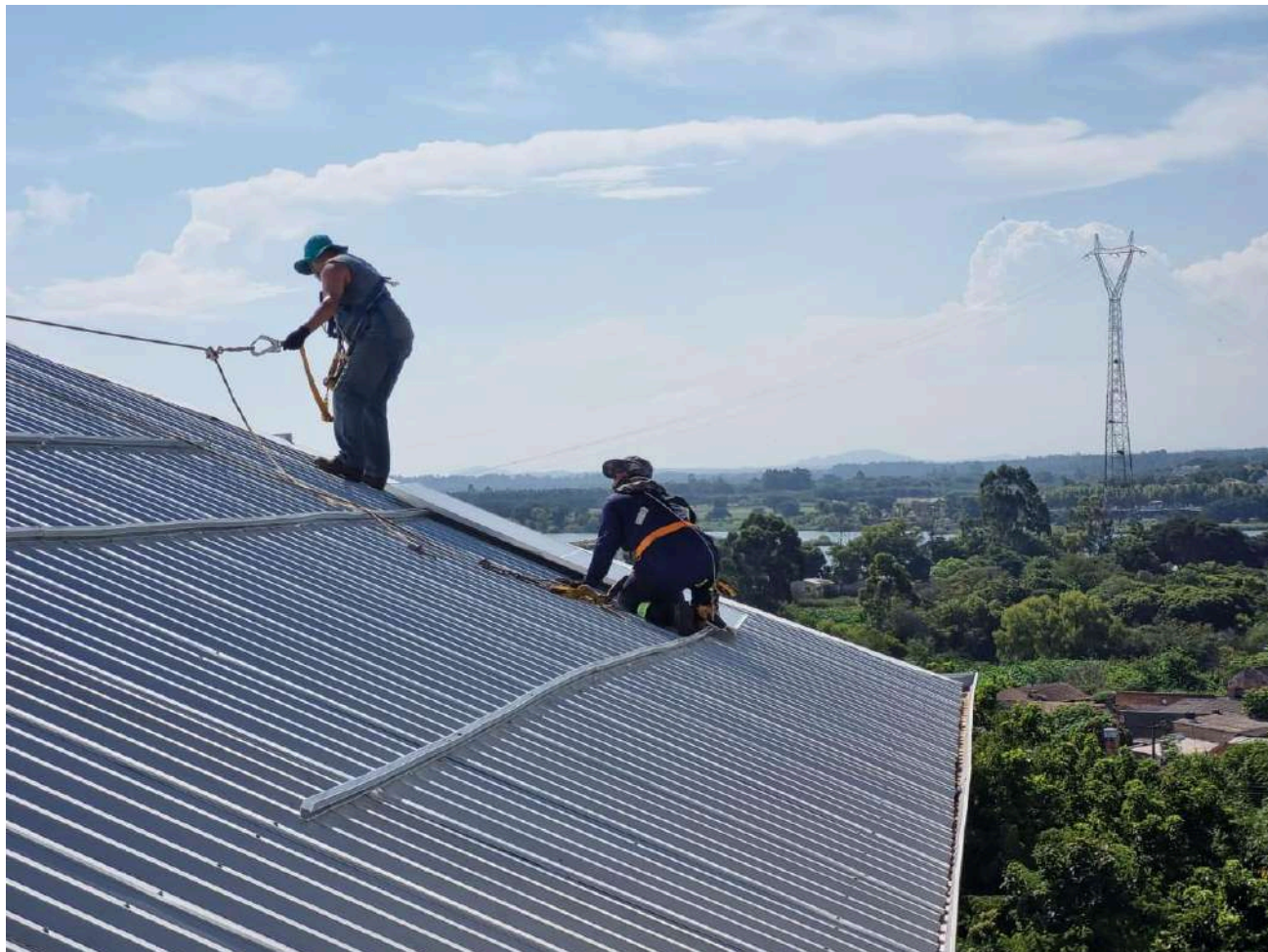
Instalação de módulos da BYD no Hospital Regional de São Jerônimo, no Rio Grande do Sul
