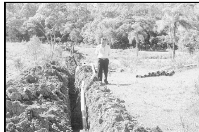
Canalização da água até a cidade
