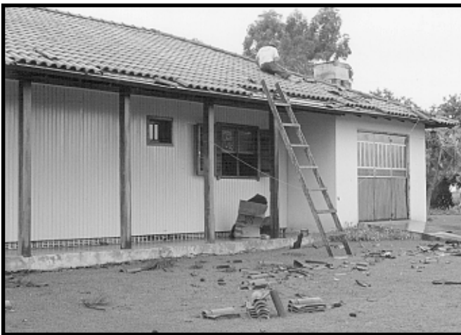
Casa de Elemar Thiesen, mais de 100 telhas destruídas
