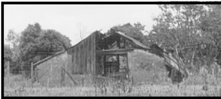
Galpão no centro da cidade destruído
