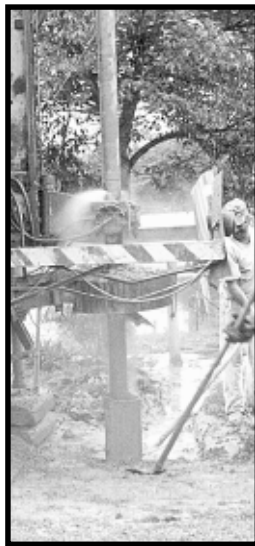
Poço perfurado ruíu
